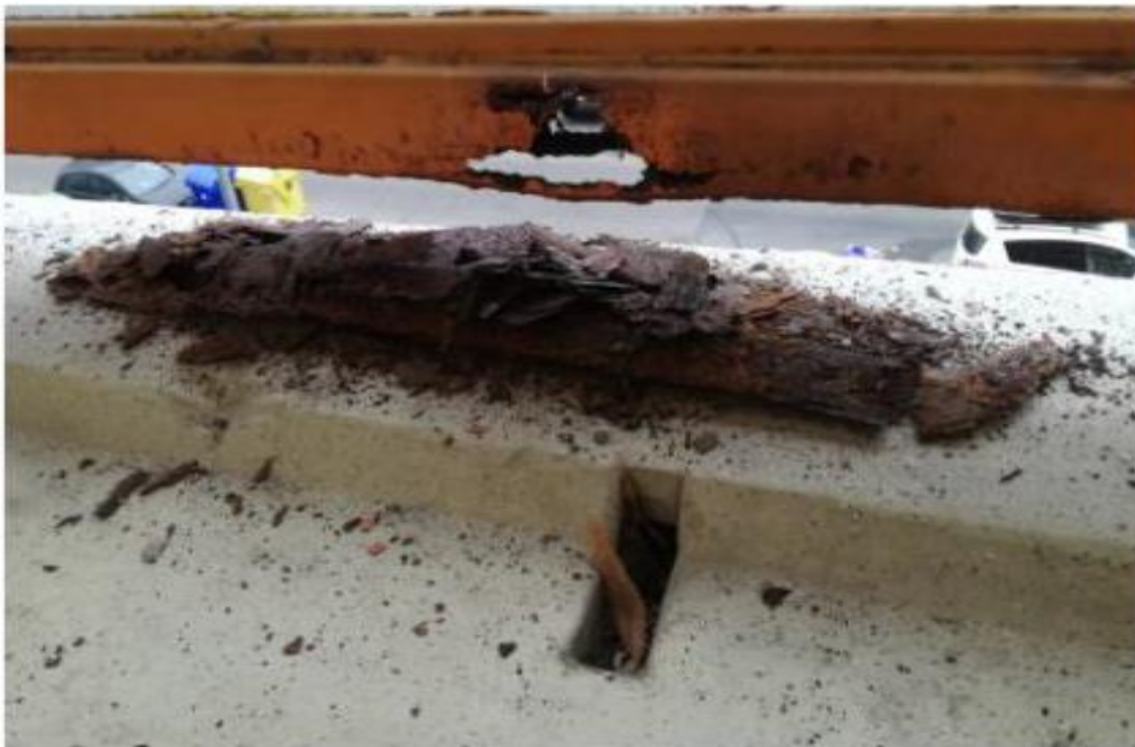
Obr. 6 Zkorodovaná dolní příče bytu č. 04 ve 4. NP, Petržilkova 2486
