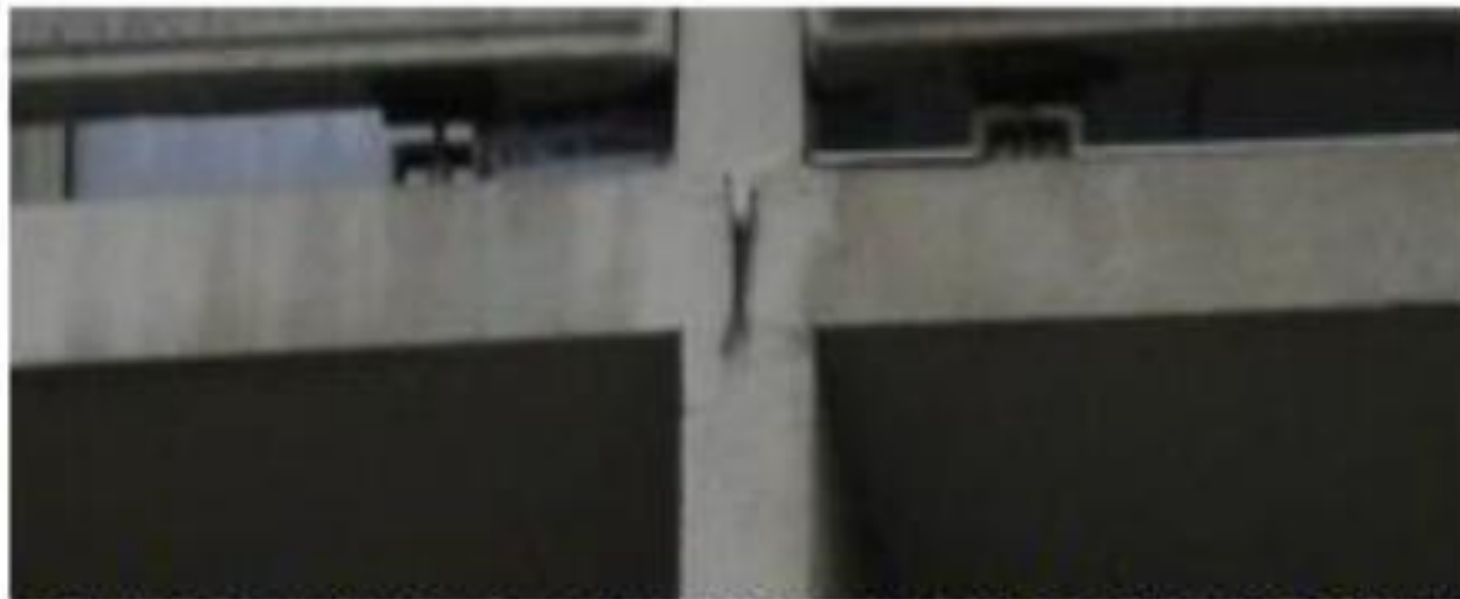
Obr. 6 Narušení styku stěnových a stropních lodžiových dílců
