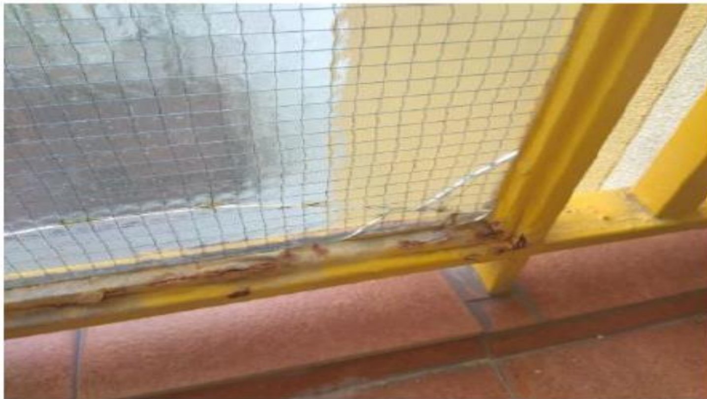
Obr.7 Byt č.12, Petržilkova 2491, zkorodovaná zasklívací lišta, prasklé zasklení,
