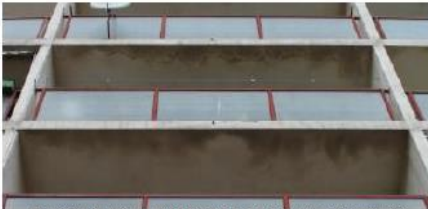
Obr. 8 Zatékání do stropních lodžiových panelů, kotvení ocelového zábradlí
