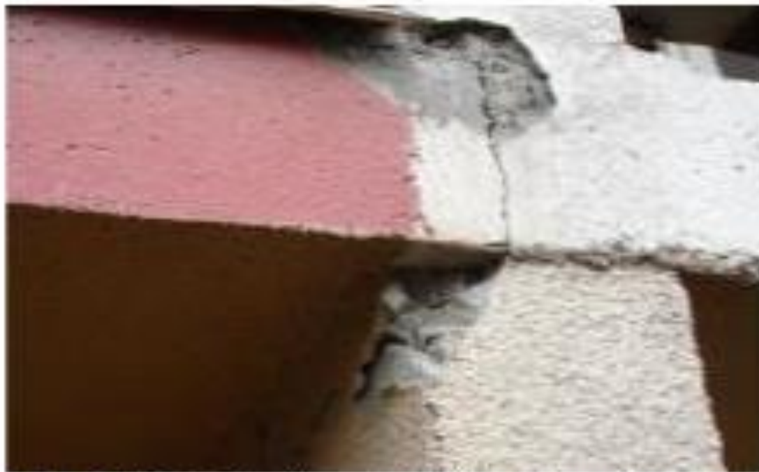
Obr. 5 Nedodržení montážních tolerancí – det. A
