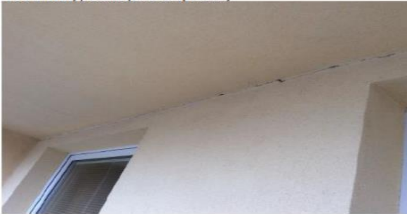
Obr. 5 Trhlinky ve fabionul stropu lodžie u jižní stěny
