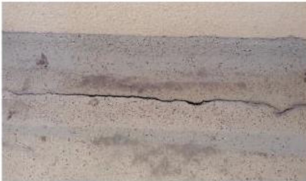
Obr. 3 Praskliny fabionu podlahy u vnější straně lodžie byt č. 3
