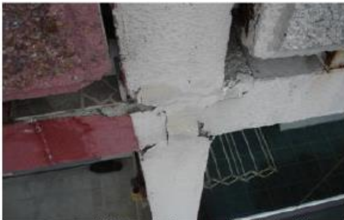
Obr. 7 Narušení styku stěnových a stropních lodžiových částí
